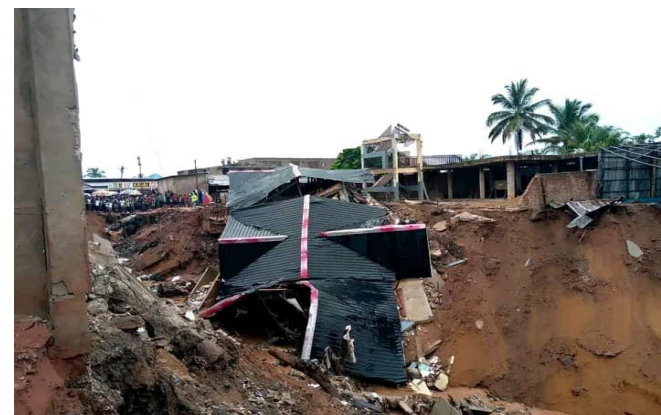
Ecole la Providence écroulée à Tshikapa suite à l'érosion
